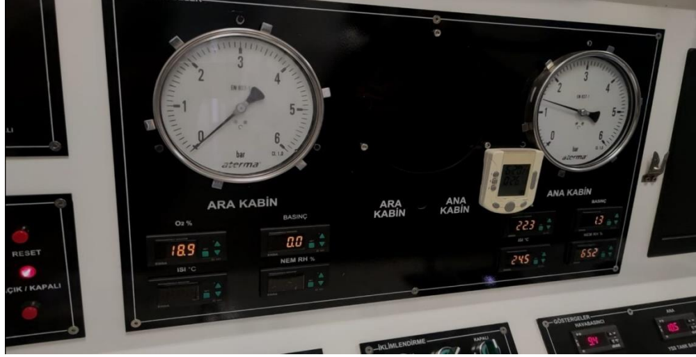
Şekil 2.11 Basınçlandırma tütünün kontrol panelindeki basınç ünitesi
