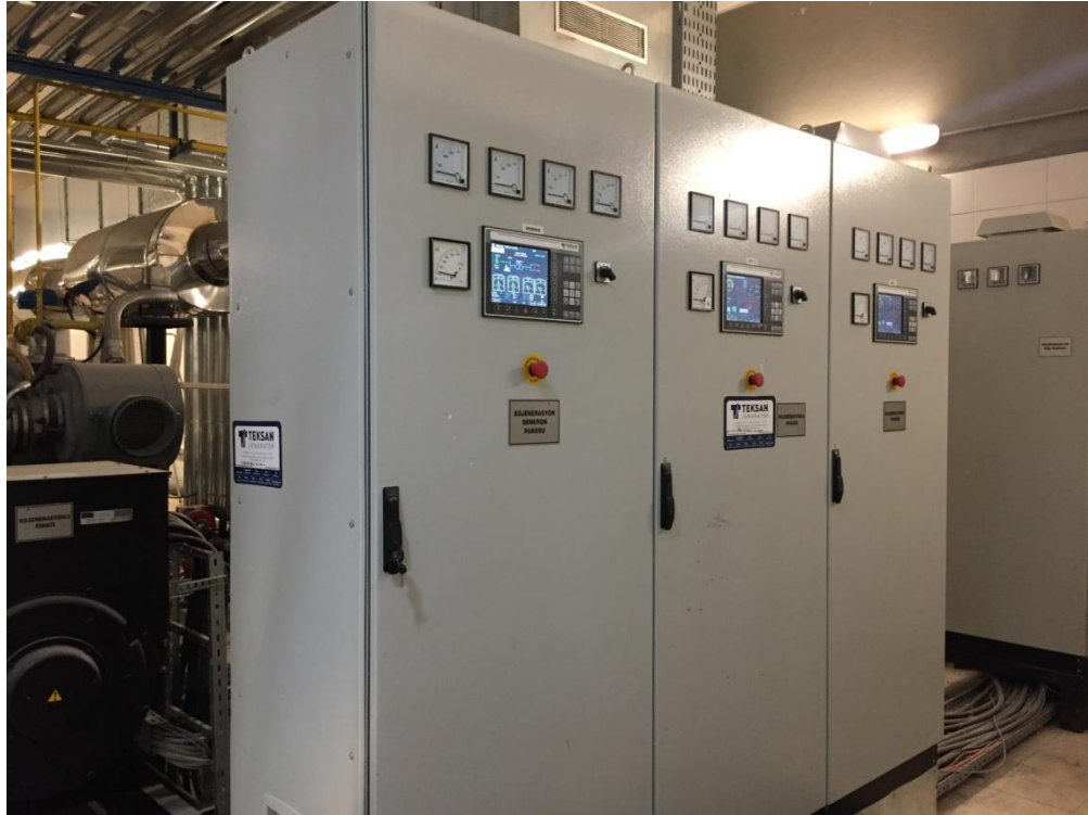
Şekil 3.19 Trijeneratör santrali kumanda panoları.
