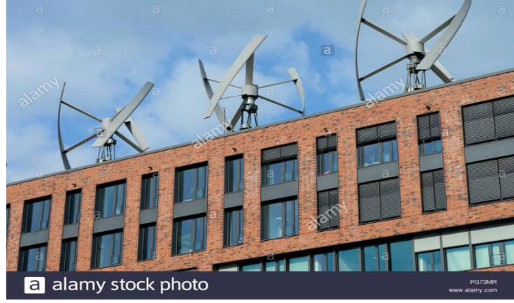
Şekil 4.5. Almanya Hamburg, Hafencity'deki Greenpeace binasının çatısındaki dikey eksenli rüzgar türbini kullanımı (Alamy. 2020).
