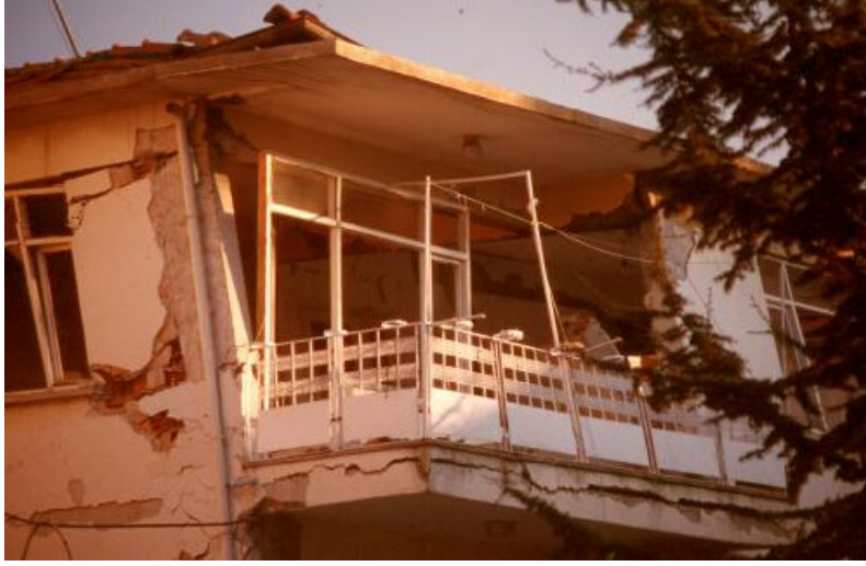
Şekil 1.8. Düzce Depremi, Konsol Yapı Elamanı Deprem Davranışı .
