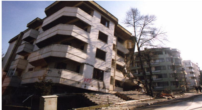
Şekil 1.10. Düzce Depremi, Kısa Kolon Etkisi .
