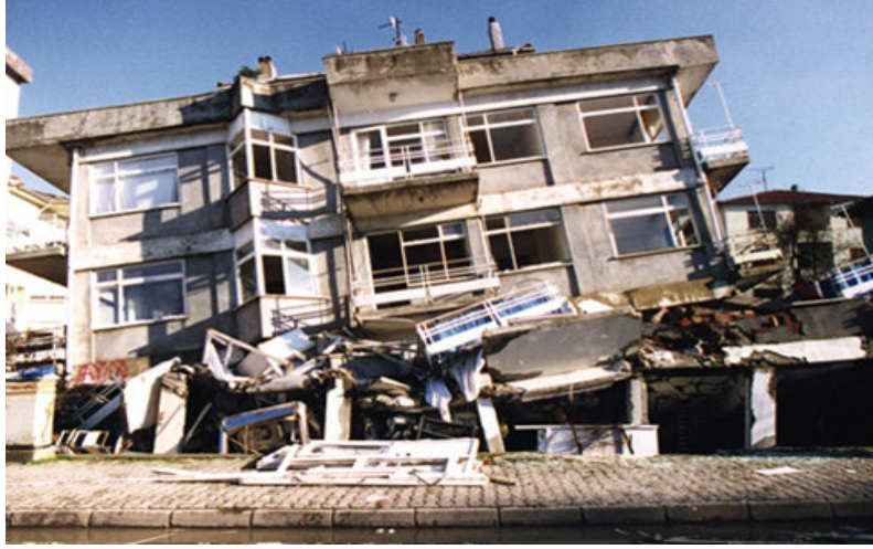
Şekil 1.9. Düzce Depremi, Yumuşak Kat Etkisi .
