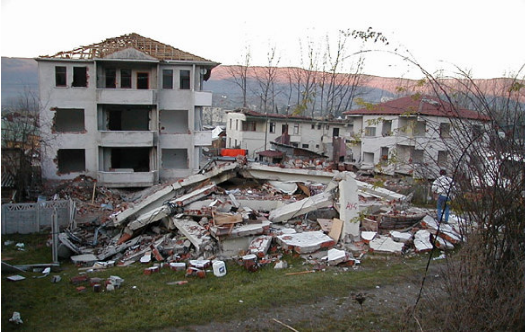
Şekil 1.5. Düzce Depremi, Rezonansa bağlı yapı hasarları .
