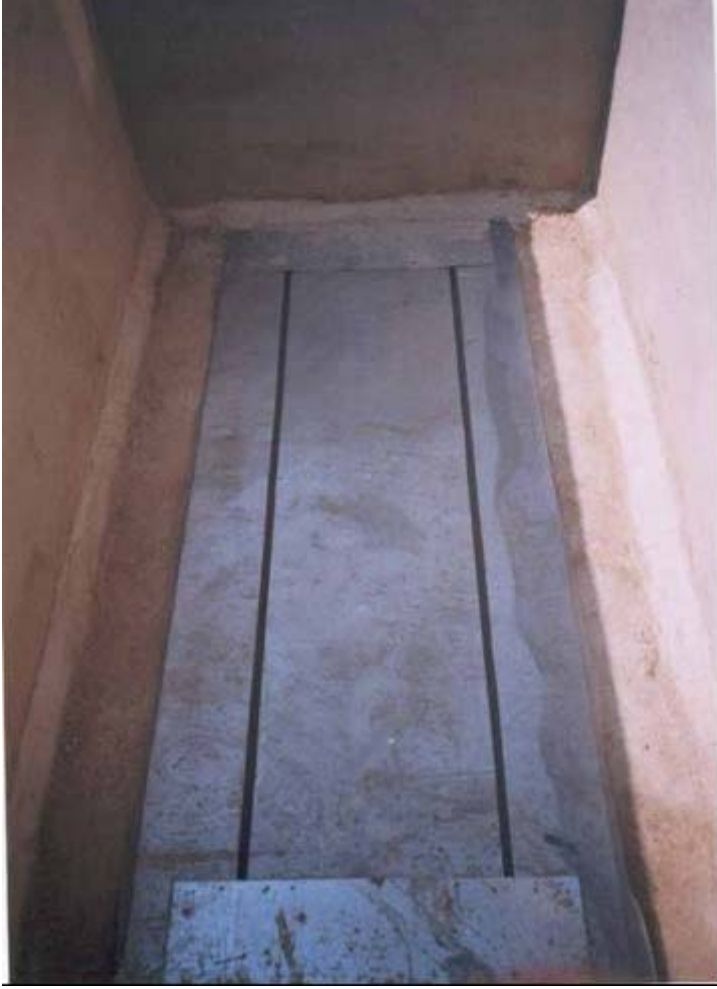
Şekil 3.6. Model depo havalandırma kanalları
