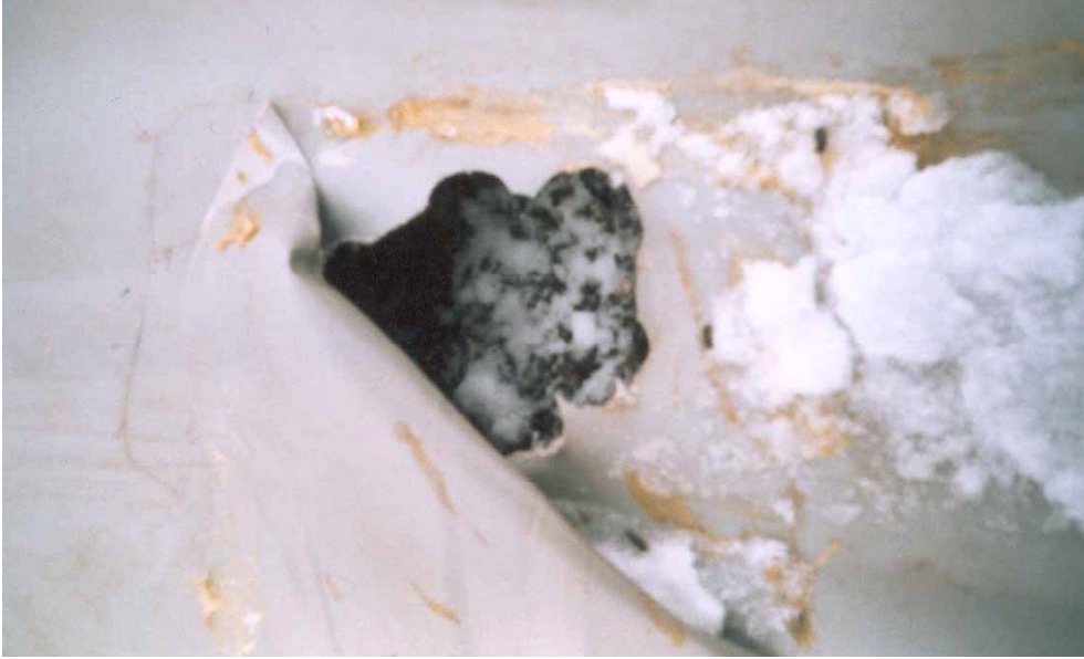
Şekil 4.10. Açık depoda havalandırma açıklıklarından giren kar
