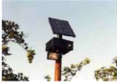
Şekil 0-18 Güvenlik aydınlatma sistemleri.
