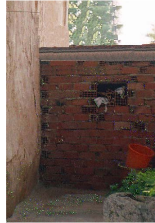
Resim A.13. Arkası Tuğla Örülerek, Kullanımı İptal Edilmiş Kapı
