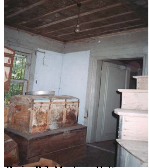
Resim B.3. Merdiven Holü ve 1.Odanın Kapısı
