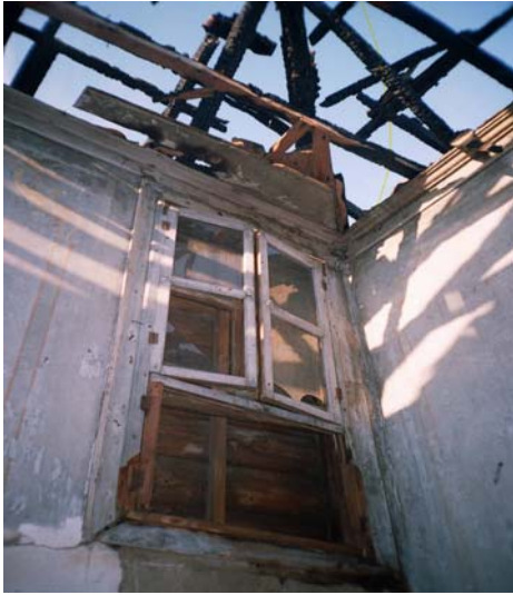
Resim B.7. Birinci Katta Hasar Gören 1.Oda
