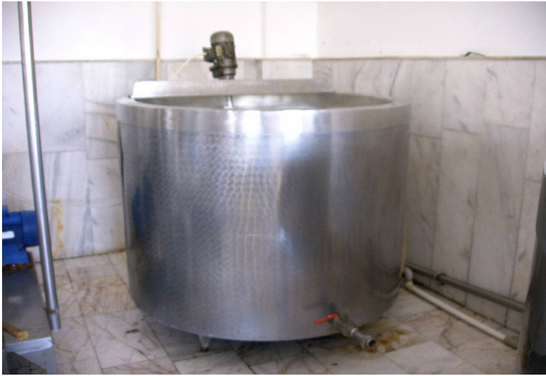
Şekil 3.2.1.2 İşletmede bulunan çift cidarlı karıştırılmalı kazanın görünümü
