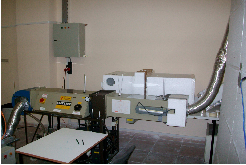
Şekil 7.5. İklimlendirme tesisatı ve toplayıcı bağlantısı
