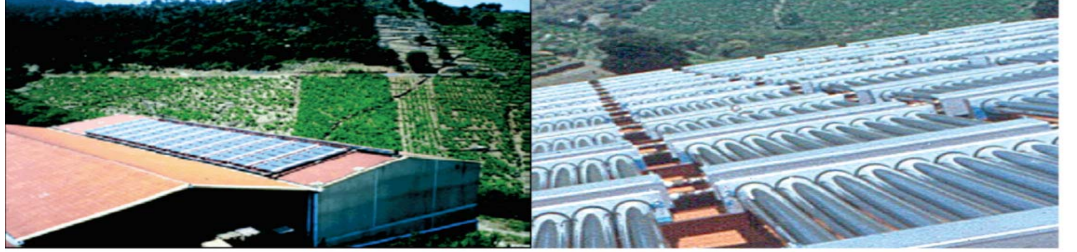
Şekil 2.4: Fransa'da Kurulu Bulunan Güneş Enerjisi Destekli Soğutma Tesis
